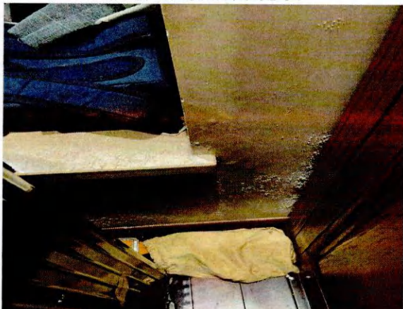
估价对象室内渗水、发霉现状
