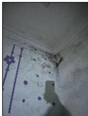
室内墙面发霉处
