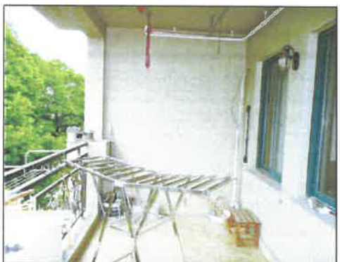
估价对象二层自搭自建阳台
