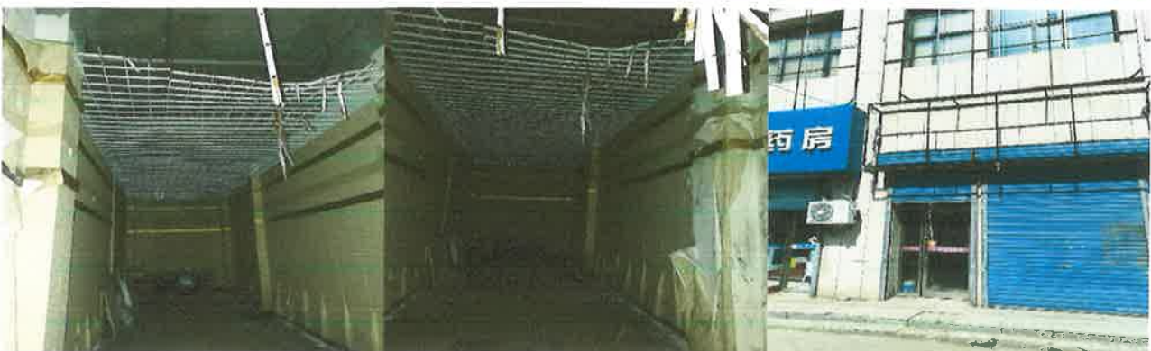
Q.Q1.Q2.Q3 楼 139 号 140 号商铺-已装修，装修破损严重
