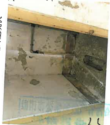
估价对象3层住宅卫生间现状
