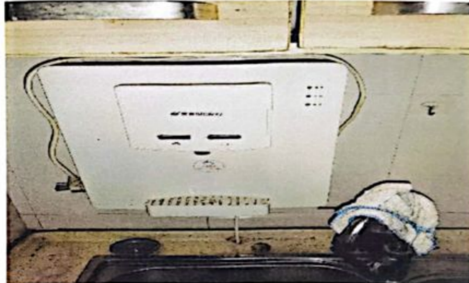
管线饮水机现状
