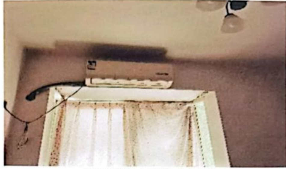
空调挂机（部分）现状
