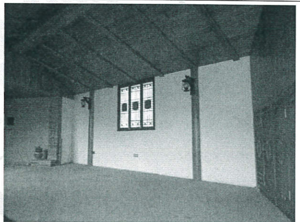
图 5-18: 违建区域七层内部设置木柱, 木柱直接搁置于钢梁上部, 与设计不符且木柱与钢梁未设置有效连接
