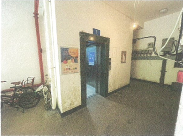
估价对象电梯
