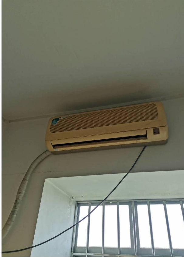
挂式空调 1 现状
