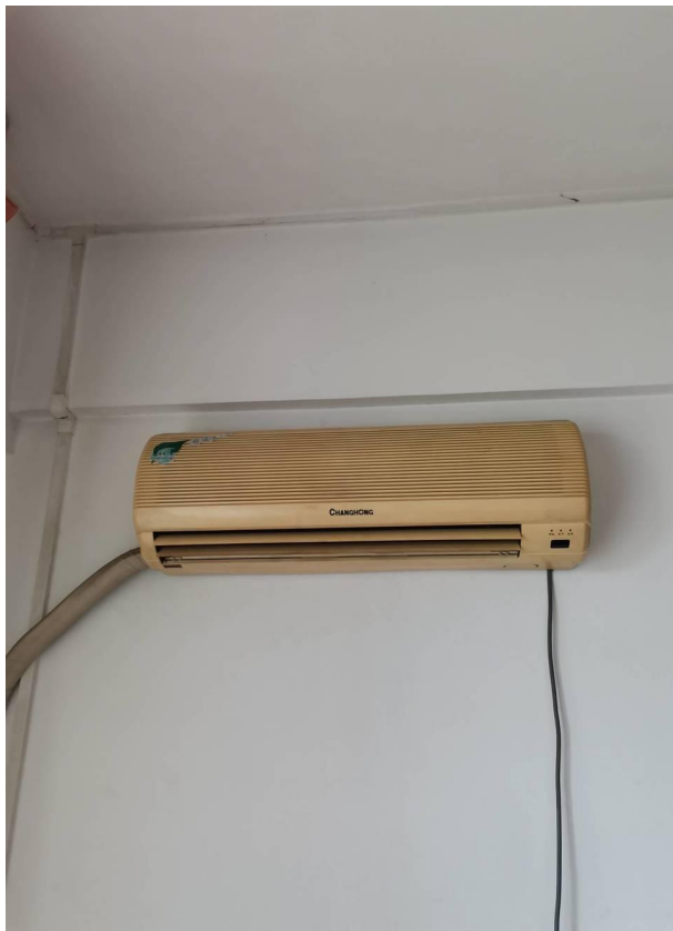
挂式空调 2 现状
