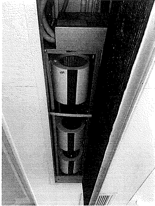
中央空调现状
