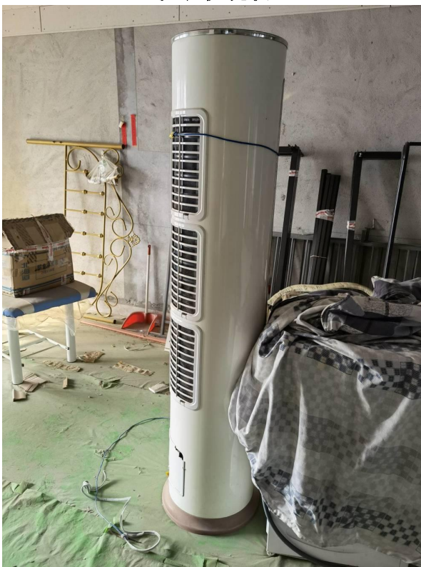
立式空调现状
