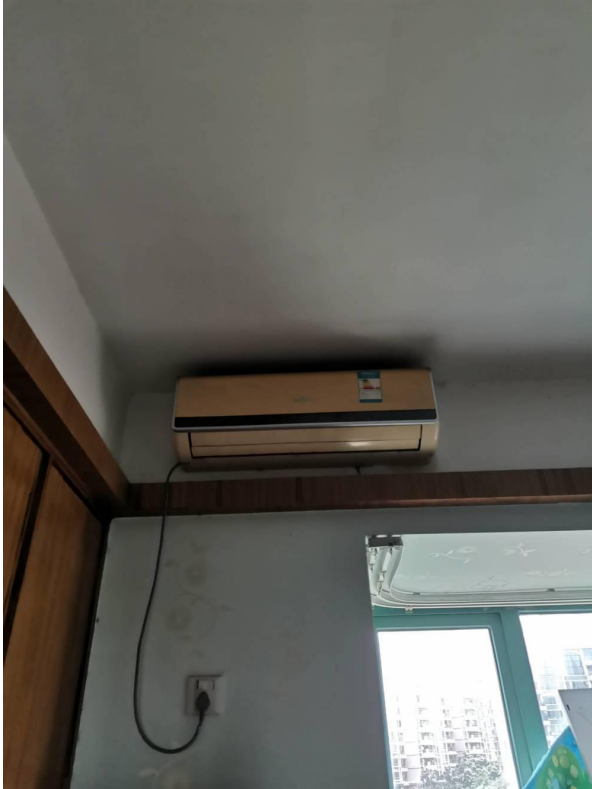
挂式空调现状
