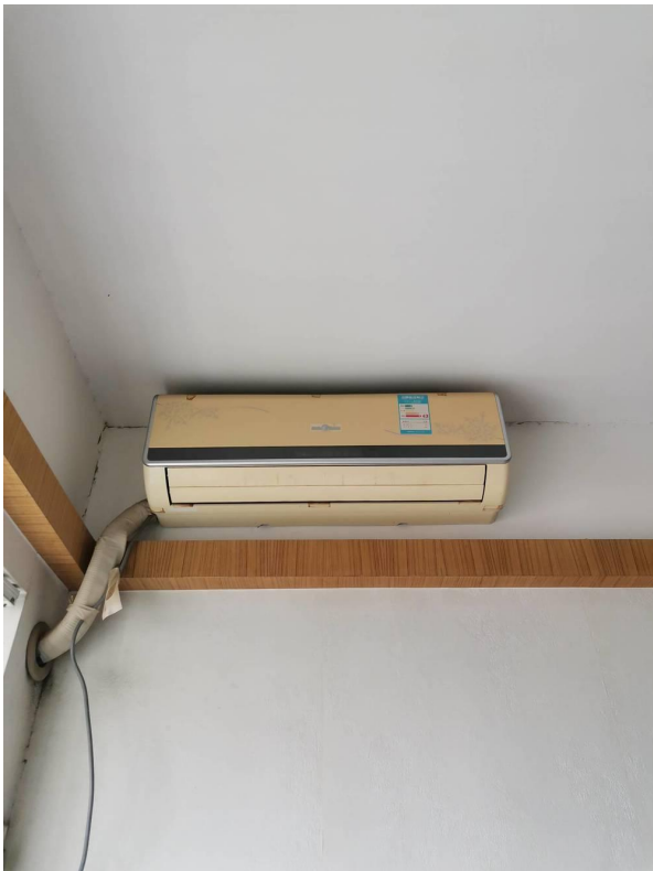
挂式空调现状
