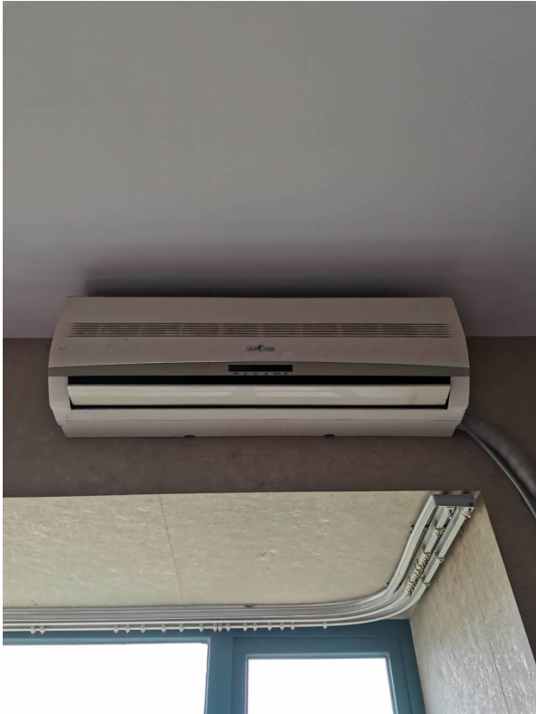
挂式空调现状
