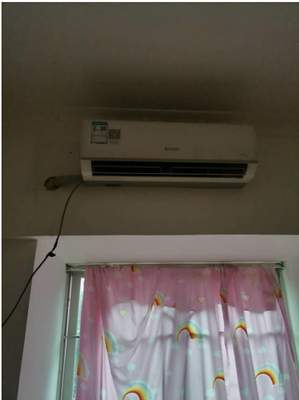
挂式空调现状
