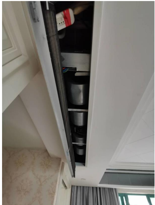
中央空调现状
