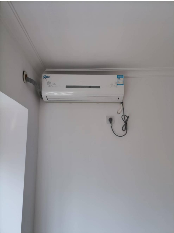
挂式空调现状
