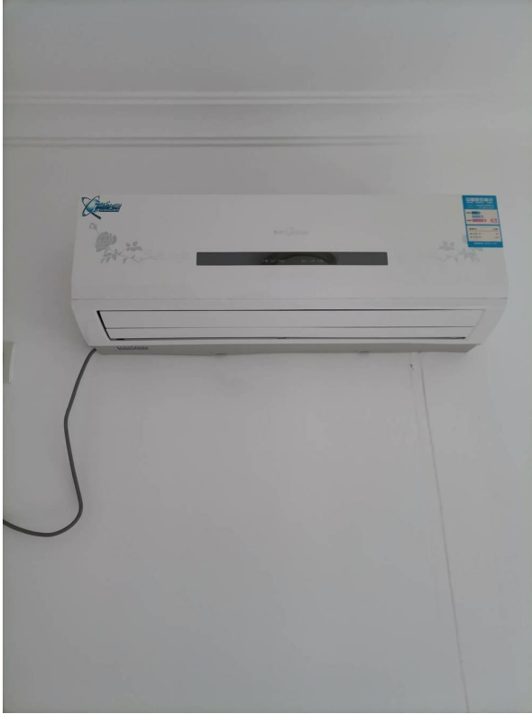
挂式空调现状
