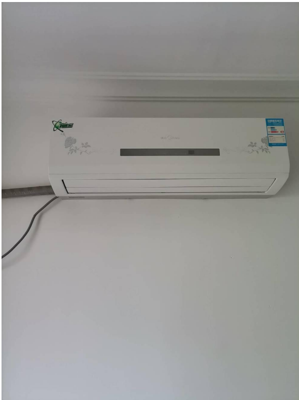
挂式空调现状
