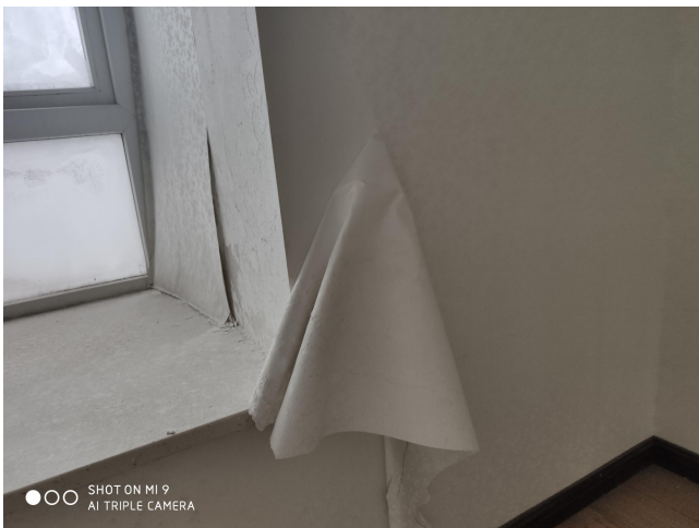
2901 室墙纸破损部分
