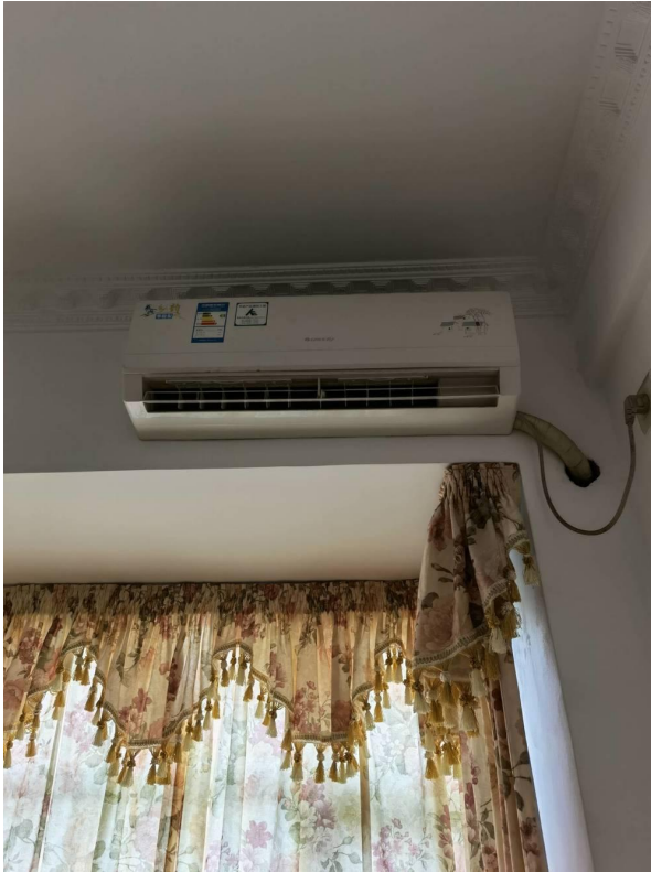
挂式空调现状
