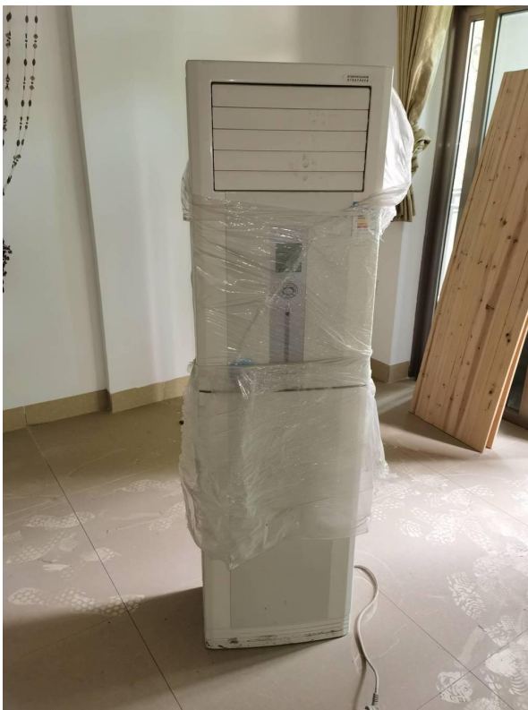
柜式空调现状
