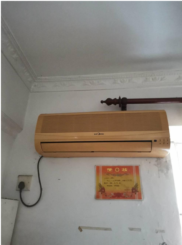
挂式空调现状
