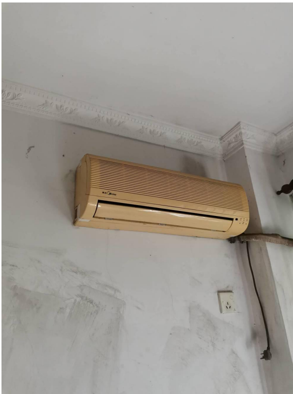
挂式空调现状
