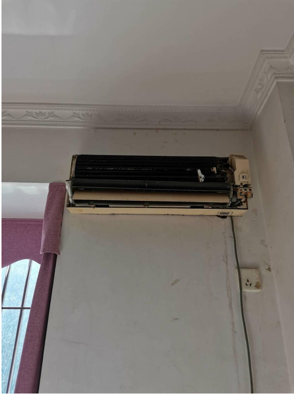
挂式空调现状
