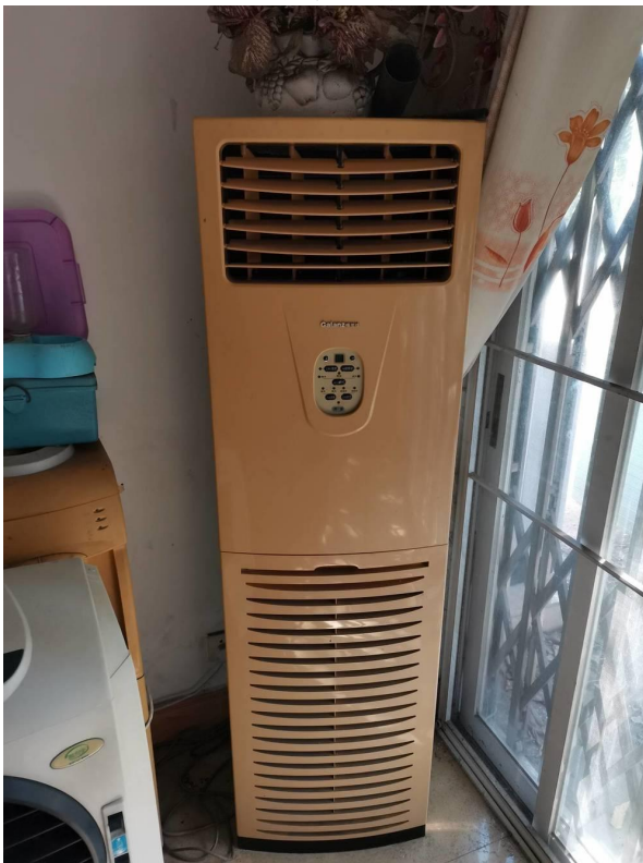
柜式空调现状
