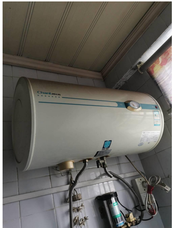
电热水器现状
