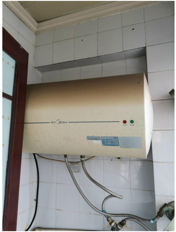
电热水器现状
