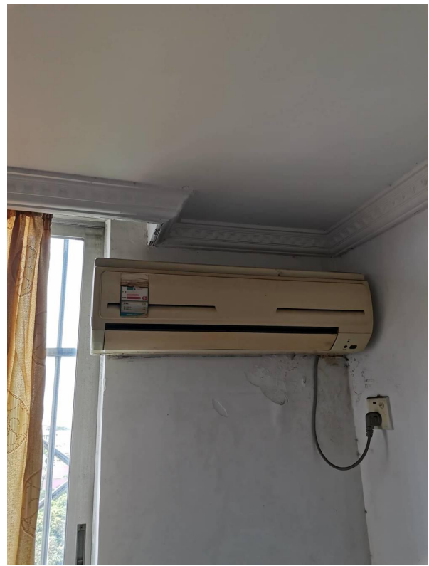
挂式空调现状
