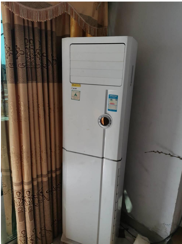
柜式空调现状
