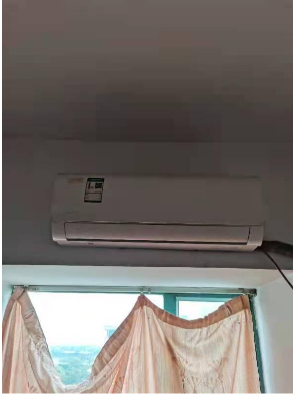
挂式空调现状
