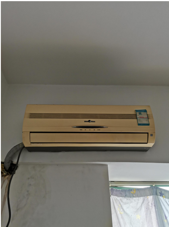
挂式空调现状
