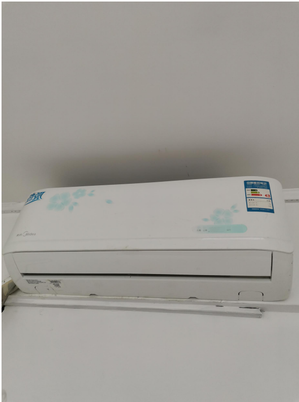
挂式空调现状
