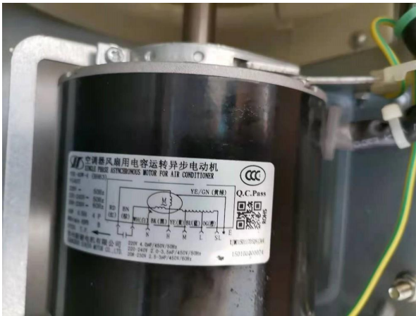
送风式空调现状
