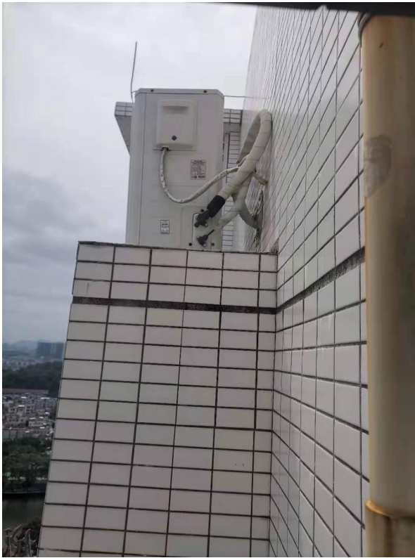
送风式空调现状
