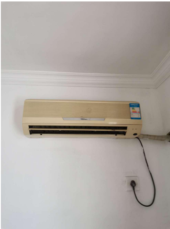
挂式空调现状
