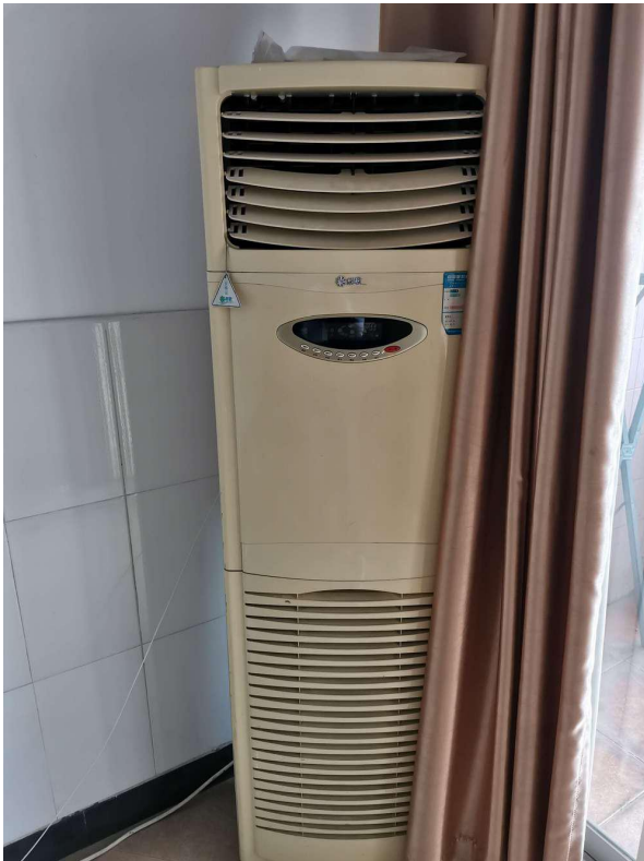
柜式空调现状
