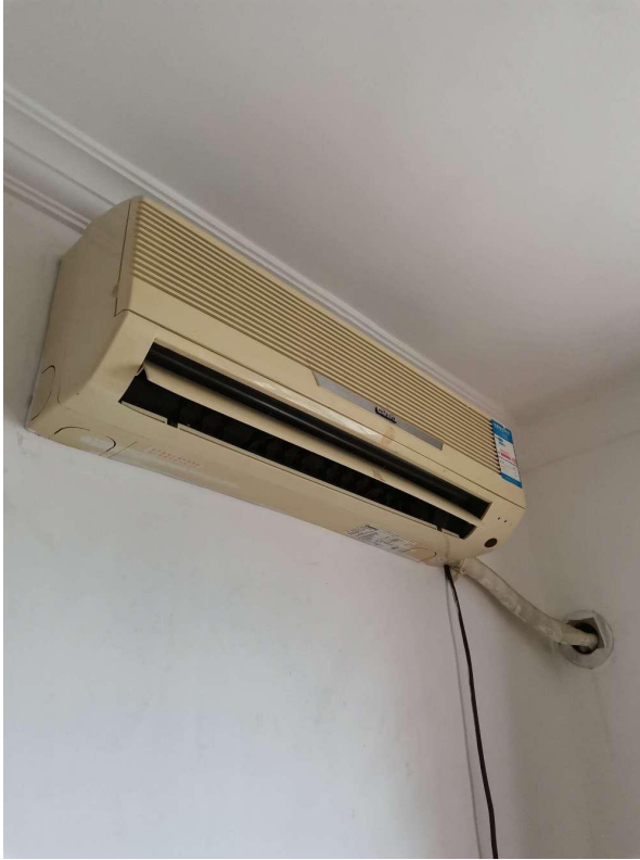
挂式空调现状
