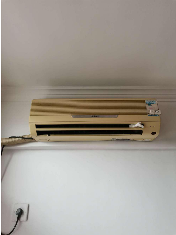
挂式空调现状
