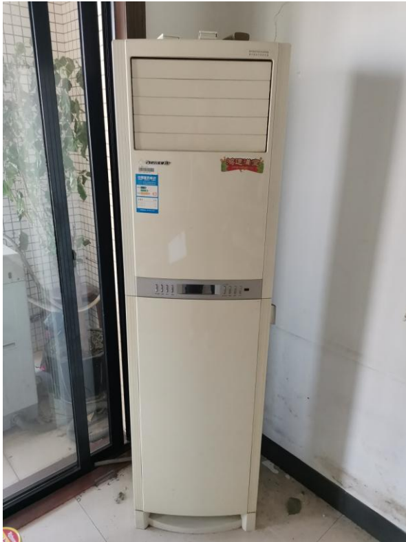
柜式空调现状
