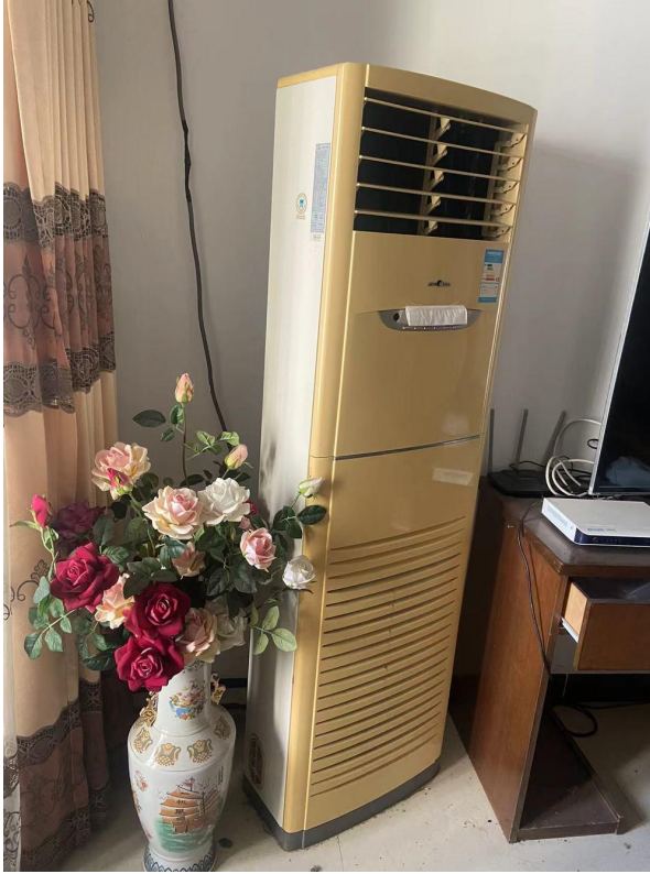
立式空调现状
