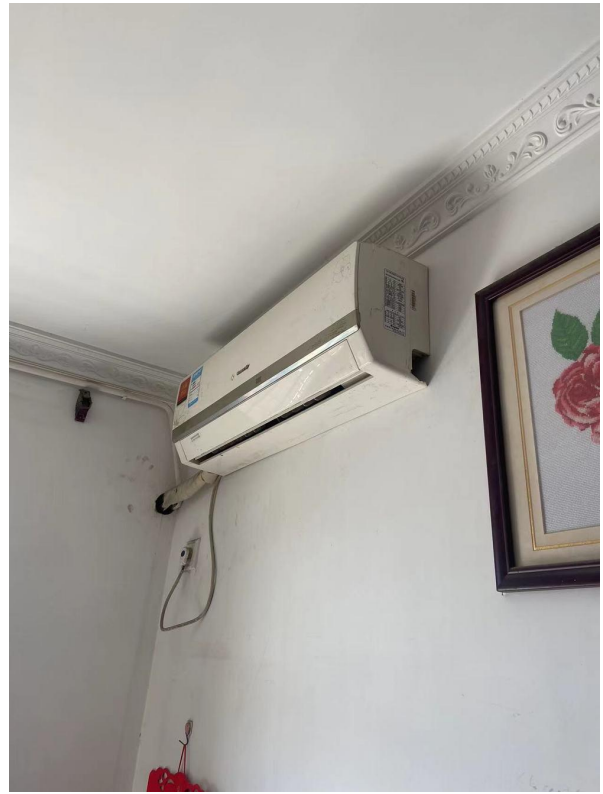
挂式空调现状
