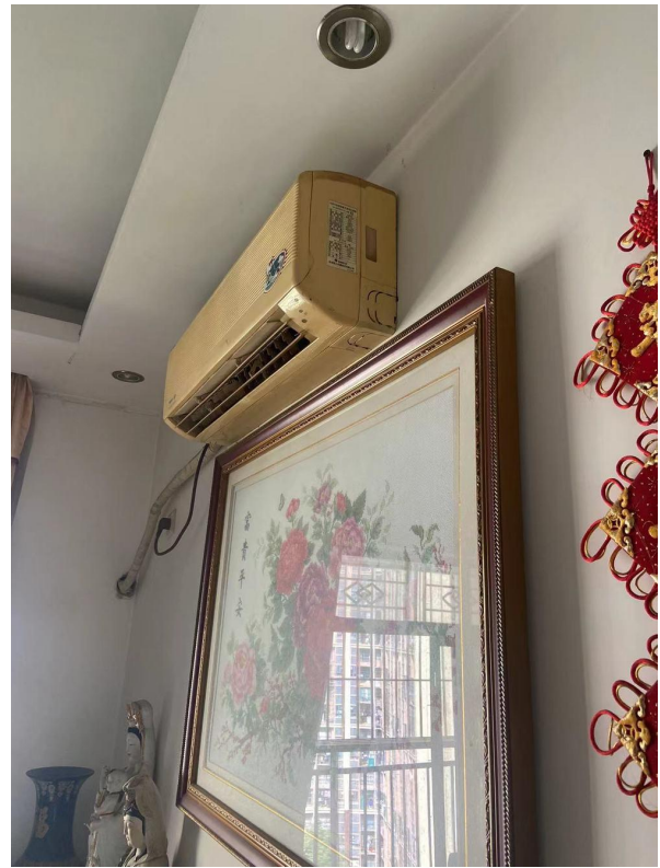
挂式空调现状
