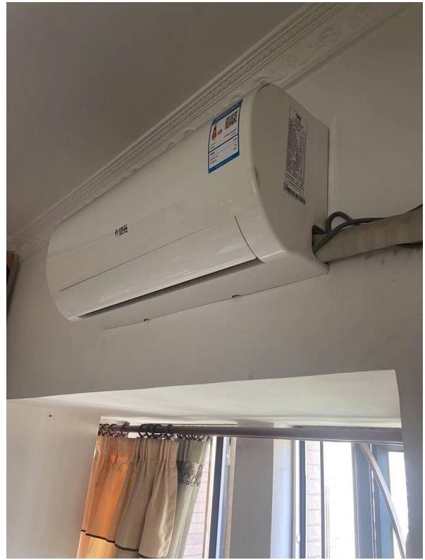
挂式空调现状
