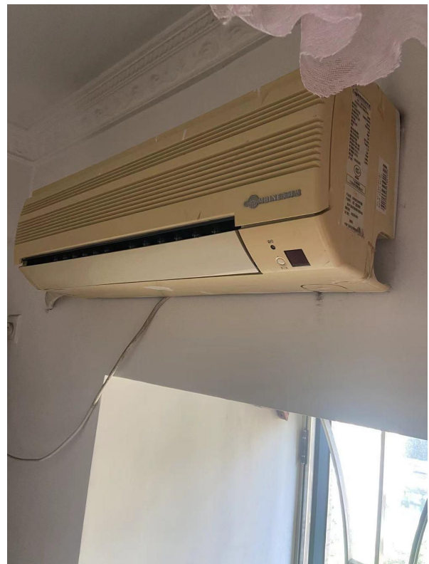
挂式空调现状
