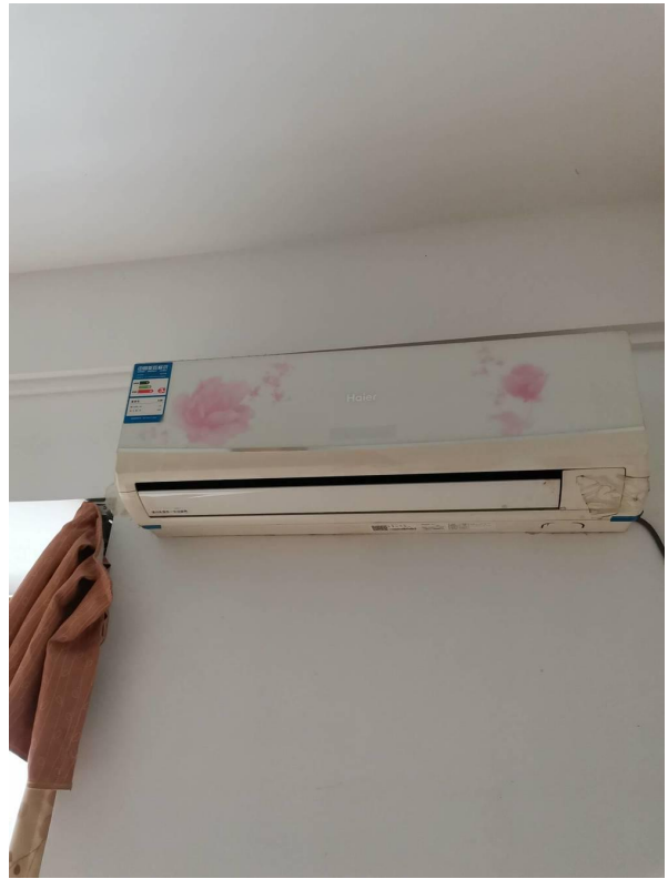
挂式空调现状
