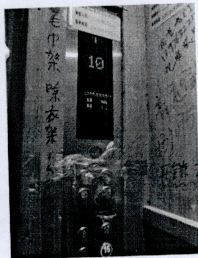
估价对象所在建筑电梯
