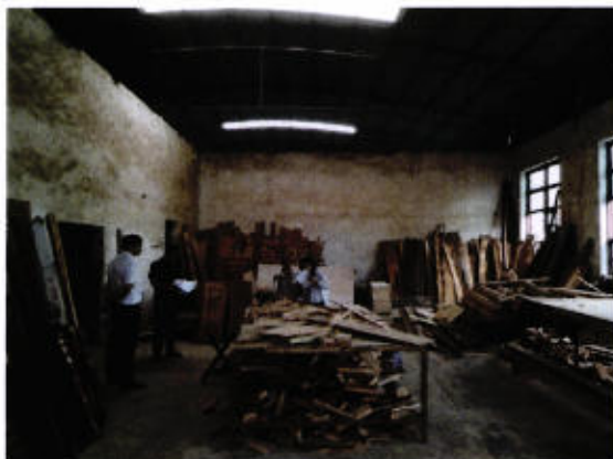
照片说明：余庆县黔龙民族药业有限责任公司名下位于余庆县龙溪镇跳蹬河房产仓库现状
