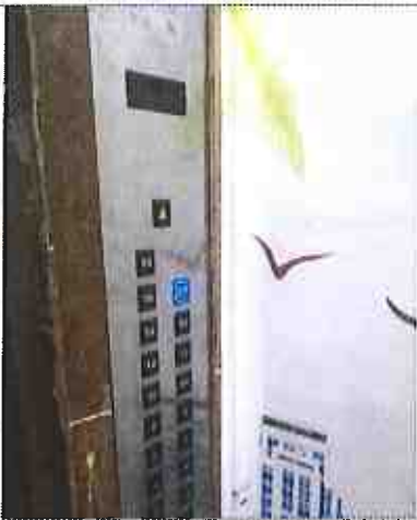
估价对象 3 单元电梯
