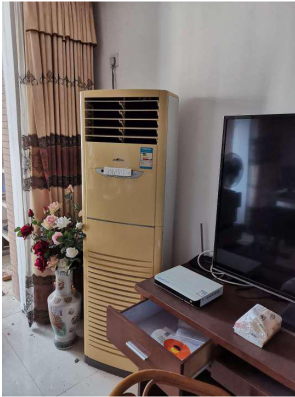
柜式空调现状
